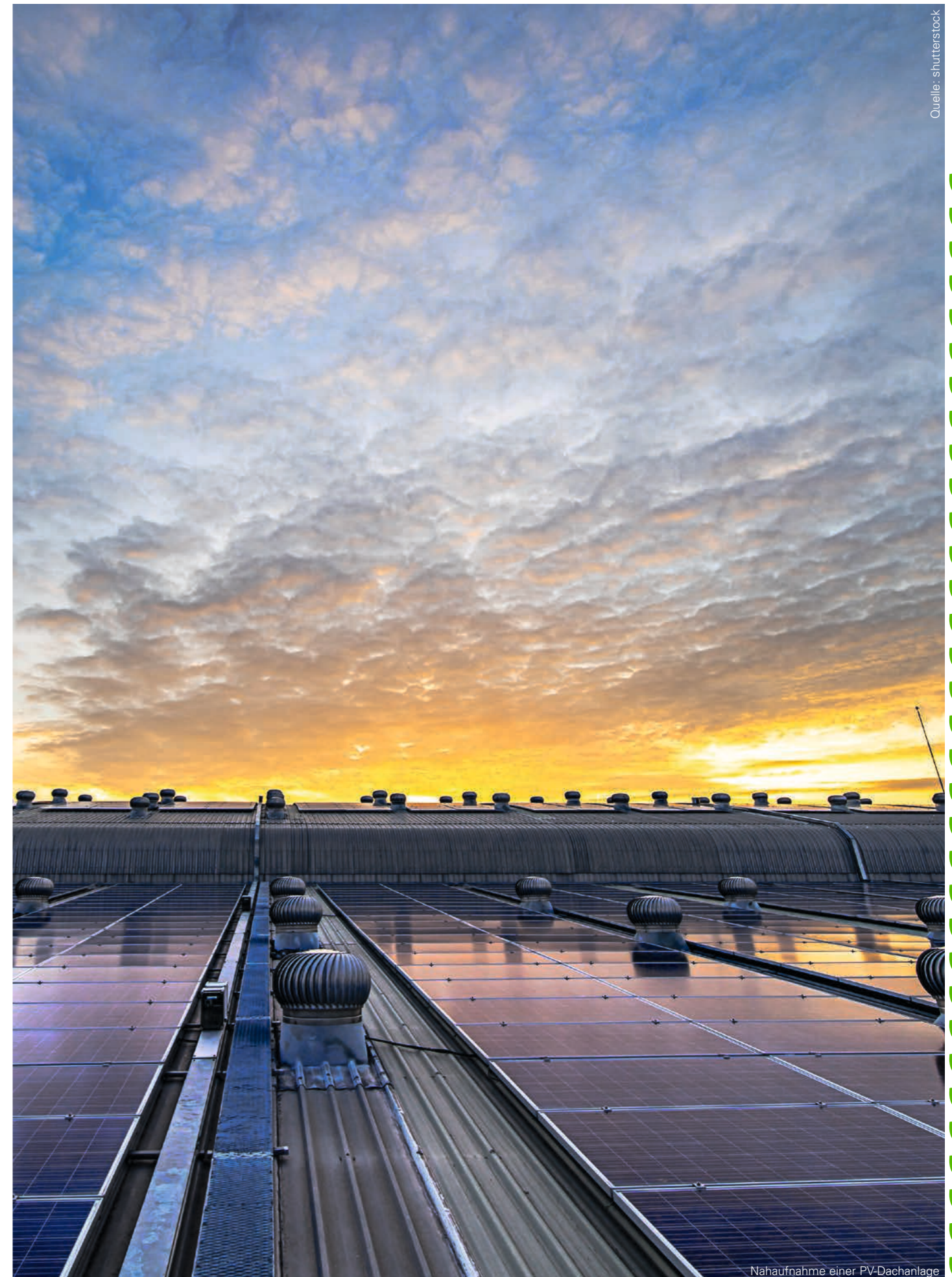
Nahaufnahme einer PV-Dachanlage
